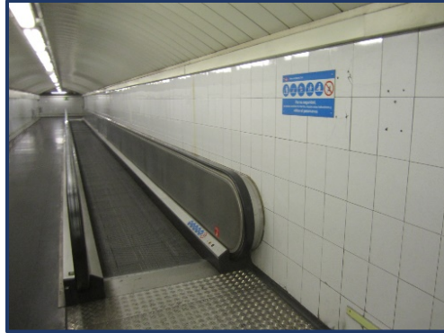
Vista del lateral del pasillo rodante
