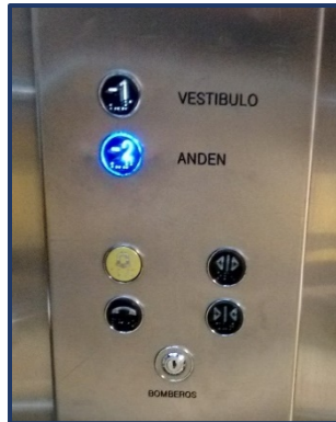
Información en botonera interior del ascensor A4
