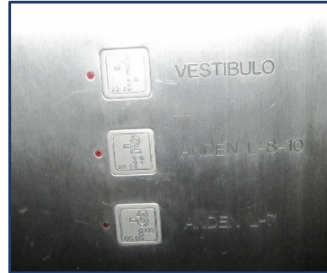
Señalización en botonera interior
