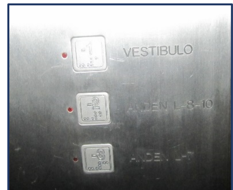
Botonera interior del ascensor
