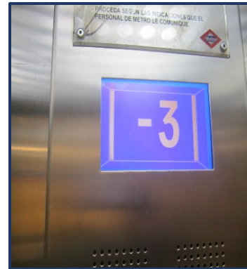
Información en la pantalla interior del ascensor A4, con nivel del andén
