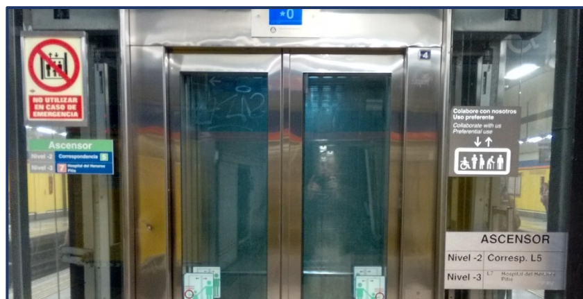
Información exterior al ascensor A4 a nivel del andén de la línea 7, en Pueblo Nuevo
