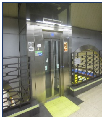
Ascensor A4. Nivel -2
